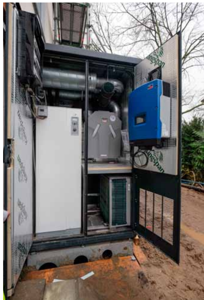
DE EERSTE ENERGIEMODULE IS INMIDDELS AANGESLOTEN
