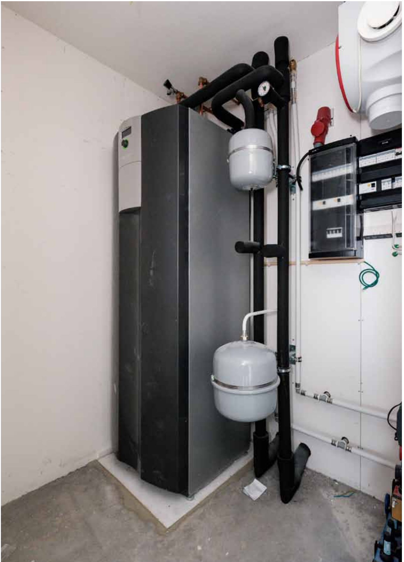
DE ALPHA INNOTEC WARMTEPOMP, GEÏNSTALLEERD OP EEN WOONARK
