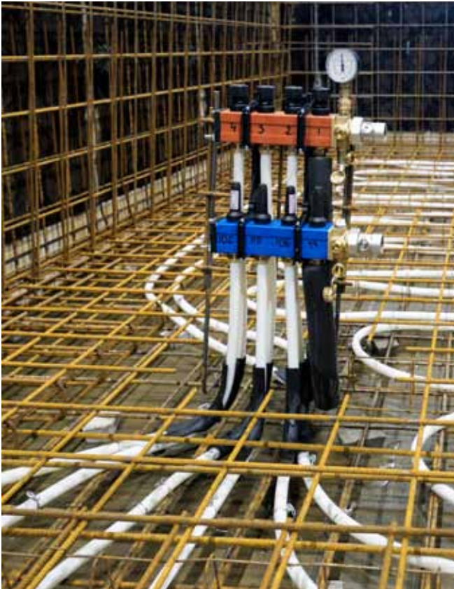
DE PREFAB LEIDINGSKID VAN NATHAN
